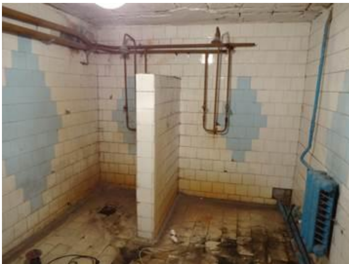
Huidige douches, de afvoer is verstopt en daardoor niet meer in gebruik.
